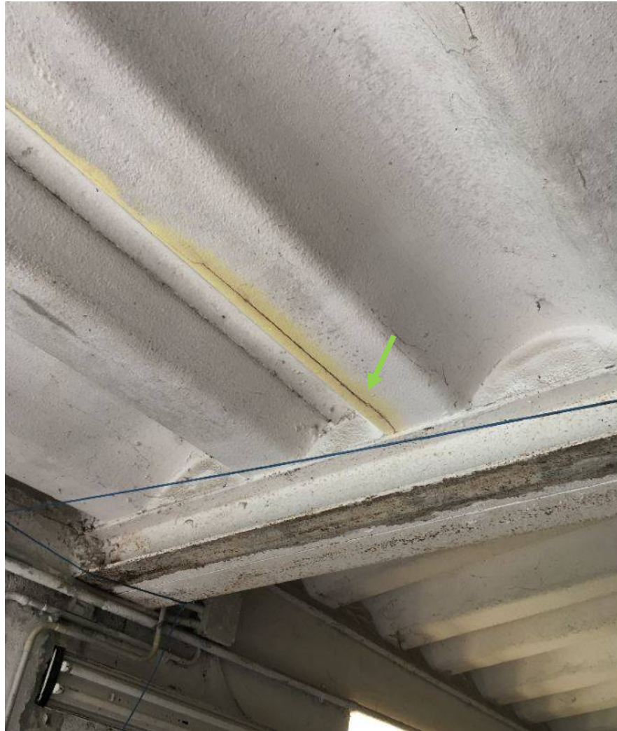
Immagine 3: Lesione in uno dei pannelli autoportanti della copertura. La linea blu visibile nella foto è nella realtà un cavo elettrico volante.
